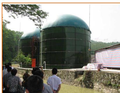
Digestores 2000 m3 mezcla completa
