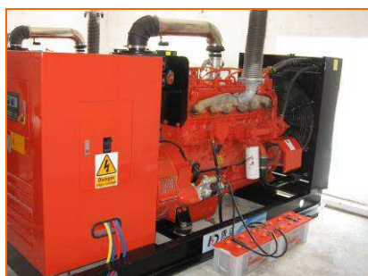
Grupo generador de electricidad
